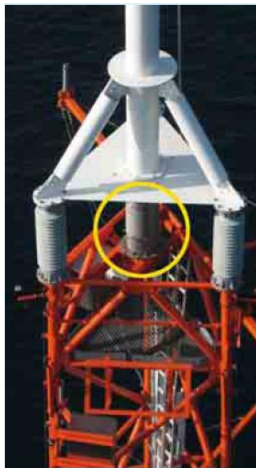
Abb. 3: VA-Stahlgehäuse unterhalb der Turmspitze mit Blitzstrom-Messkomponenten
